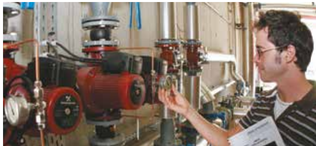
Un contrôle régulier des installations permet de limiter les surconsommations d'énergie.
