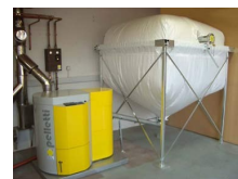
Chaudière automatique au granulé et silo de stockage
