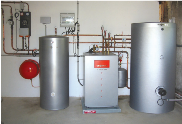
Pompe à chaleur géothermique reliée à un ballon tampon pour le chauffage et à un ballon d'eau chaude sanitaire.
