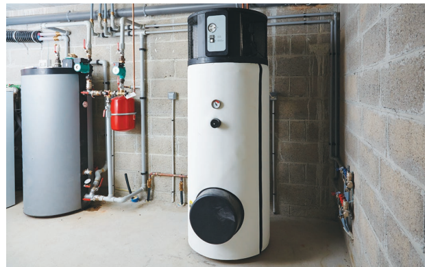
Chauffe-eau thermodynamique installé dans un sous-sol.
