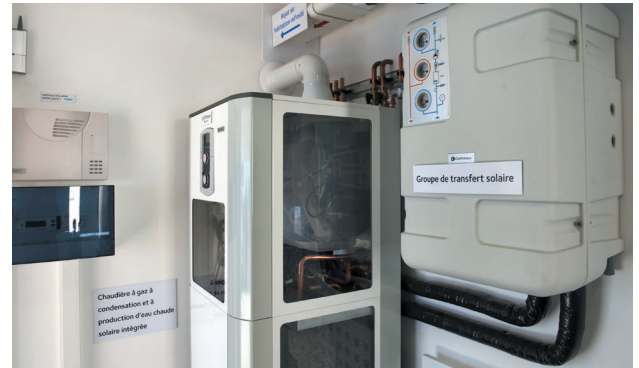
Cette chaudière à condensation au gaz est couplée à une installation solaire pour la fourniture d'eau chaude.
